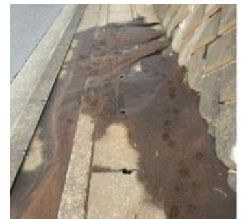
現場の土砂流出の状況
