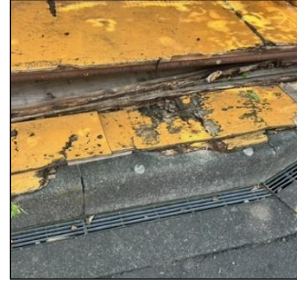
③敷板破損 敷板が腐って危険状態
