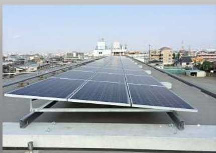
伊勢原小学校校舎屋上太陽光発電設備
