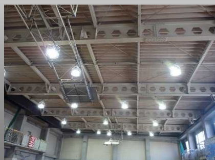
伊勢原小学校体育館のLED照明設備
