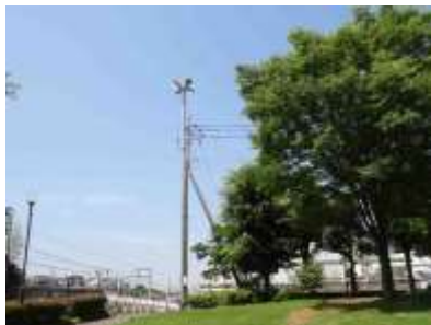
防災無線屋外子局全体
