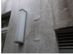
壁の爆裂 (コンクリート内部 の鉄筋の錆による 膨張)
