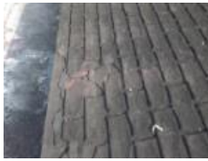
屋根材の破損
