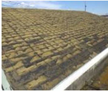
屋根材の経年劣化
