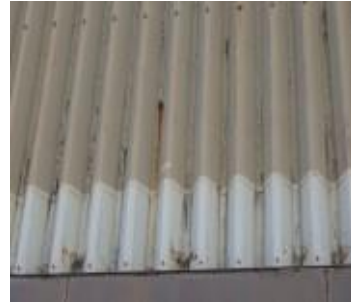
外壁鋼板に多数の発錆
