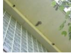
庇の爆裂 (コンクリート内部 の鉄筋の錆による 膨張)
