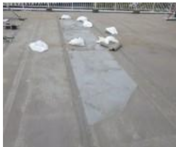
防水シートの破損
