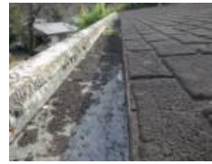
塗膜防水の剥がれ (防水塗装の剥離)
