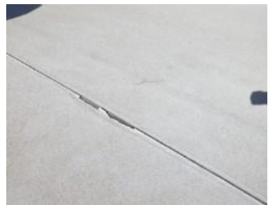
シート防水の破損
