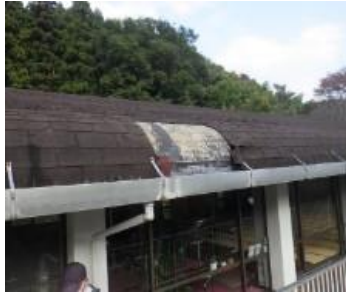
屋根の剥がれ
