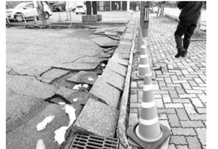
破損したアスファルトや道路側溝
