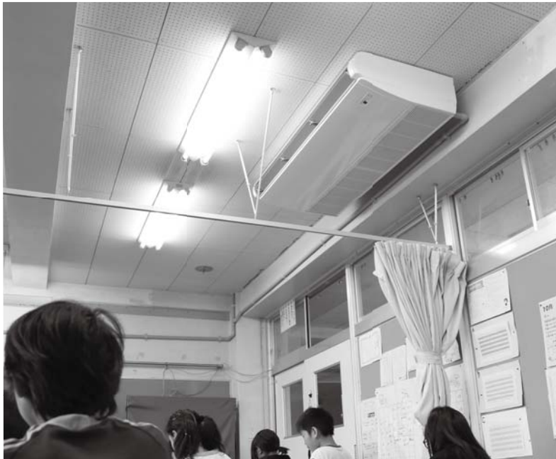
全小中学校に設置されたエアコン (写真は大田小学校の普通教室)
